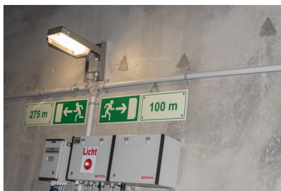
Abbildung 50: Fluchtwegkennzeichnung unter Notbeleuchtung
